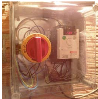
Figura 6. Variador de freqüència
