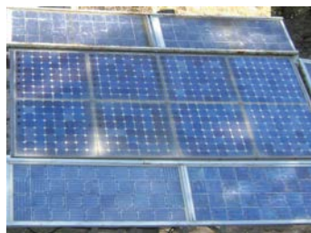
Figura 8. Plaques d'energia solar tèrmica
